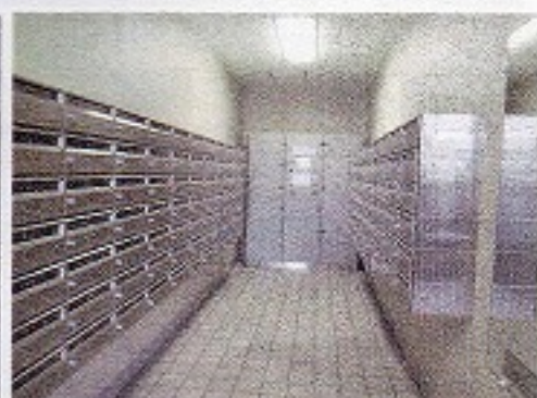
宅配ロッカー設置
